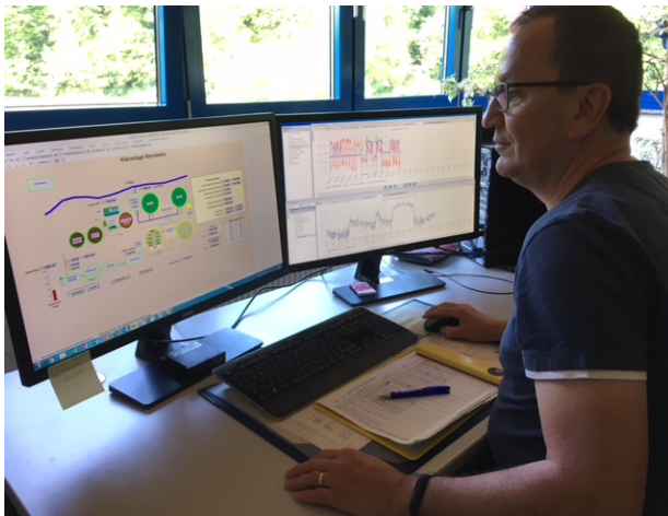
Abwassermeister Wilfred Back am zentralen Leitsystem
