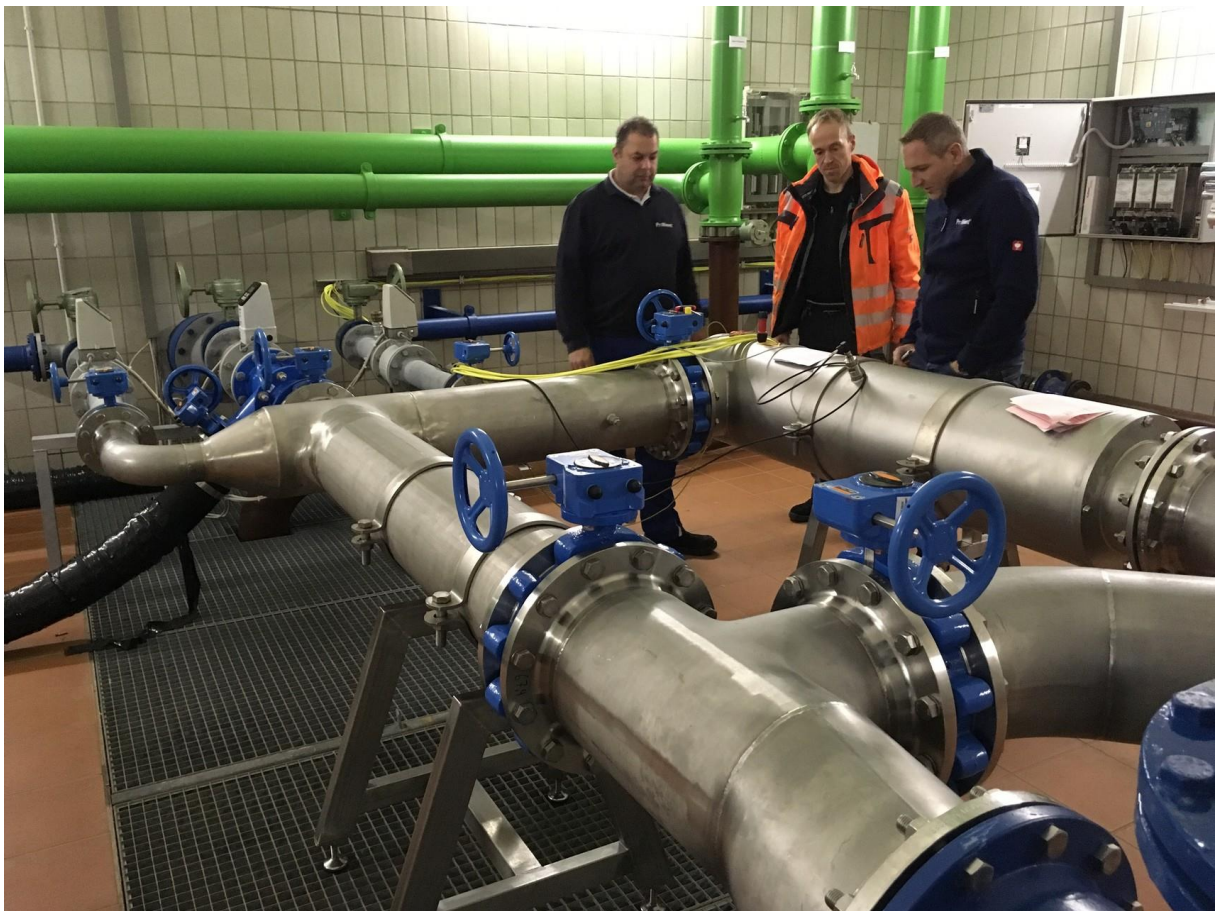
Das Foto zeigt Mitarbeiter der Fa. ProMinent (Hersteller der Anlage) sowie den stellvertretenden Wassermeister Sascha Krämer bei Inbetriebnahme der UV-Anlage im Hochbehälter Schocken. Die
